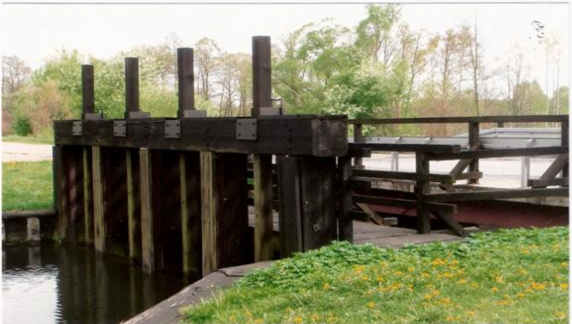
Fot.7. Widok na konstrukcje jazu w Malenīcu od strony wody górnēj – lipiec 2010 r.
