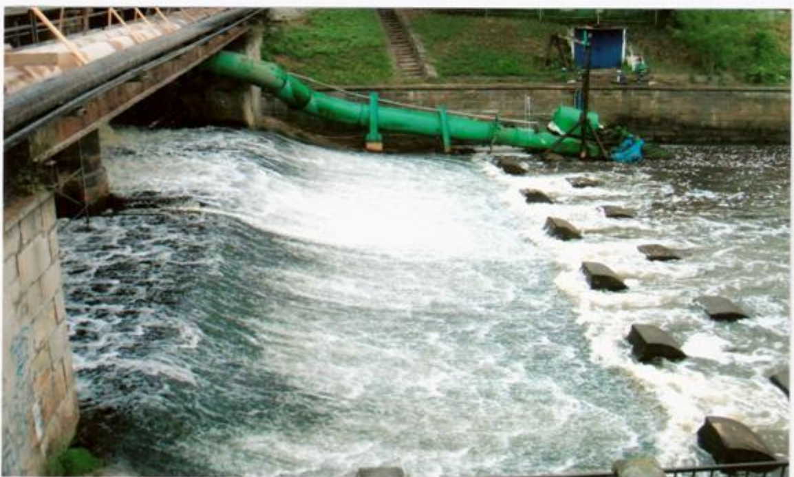
Fot. 20. Widok na elektrownię wodną - stanowisko dolne
